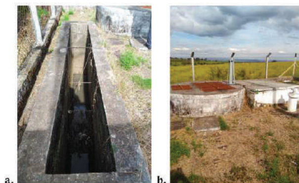
Figura 145 - EEE Aeroporto – Gradeamento, caixa de areia (a) poço de sucção (b).
