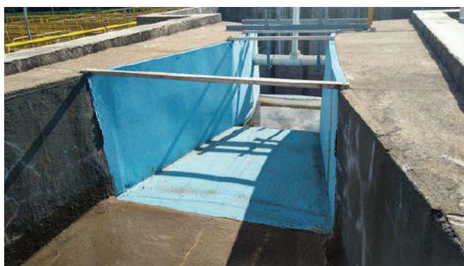
Figura 103 - ETA - Calha parshall.
