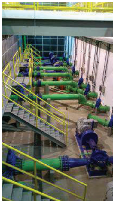
Figura 107 - Complexo de Integração dos Sistemas Norte e Sul - R5A - Casa de bombas do sistema de integração, com isolamento acústico.
