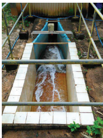
Figura 143 - ETE Jardim Luíza - Saída do efluente tratado.
