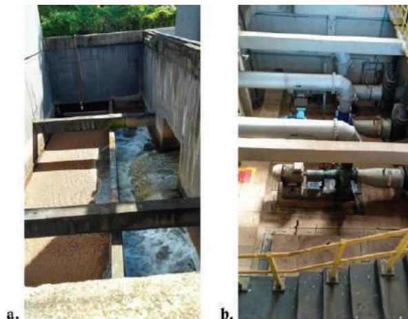
Figura 119 - ETE Franca - Setor 1 - Poço de sucção após o tratamento preliminar e retorno do processo de tratamento (a) e EEEB – vista interna (b).
