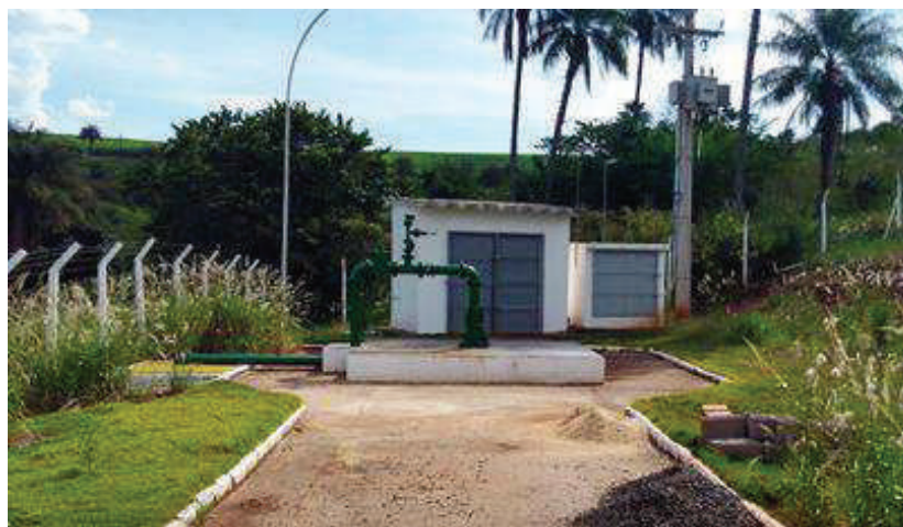
Figura 44 - Captação Subterrânea do Sistema Restinga - Vista geral do P2.
