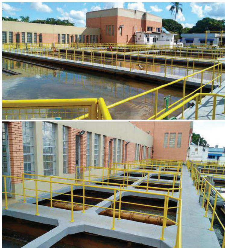
Figura 50 - ETA - Decantadores e 7 Filtros em concreto.
