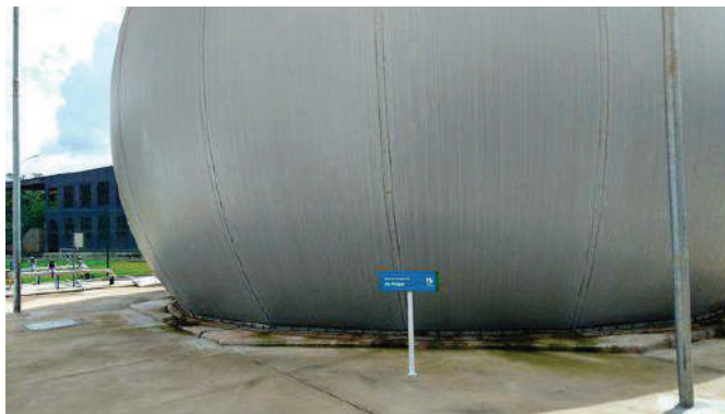
Figura 128 - ETE Franca – Setor 6 - Sistema de Beneficiamento do Biogás - Reservatório de biogás.
