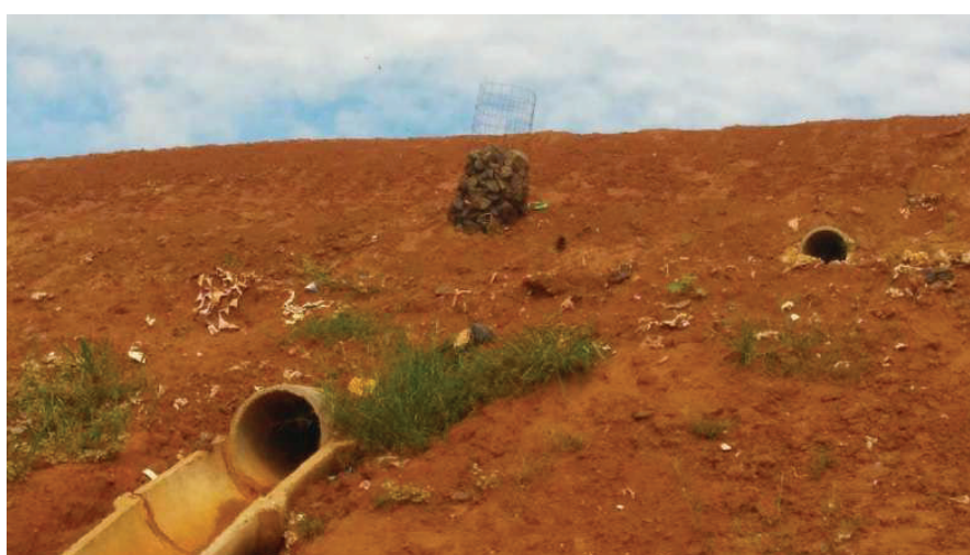
Figura 186 – Drenos de gás e Canaletas no Aterro municipal.
