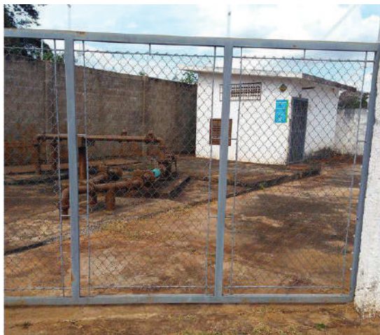
Figura 147 - ETE Santa Barbara II – Vista geral.
