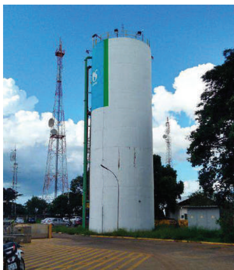
Figura 59 - Sistema ETA (Setor I) - Reservatório TNI.
