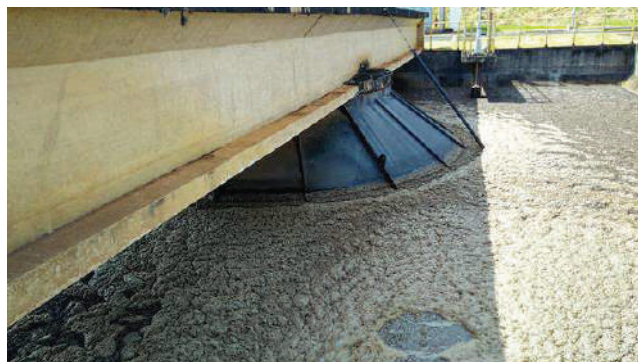
Figura 122 - ETE Franca - Setor 3 - TA1 - Aerador de superfície com campânula para retenção de aerossol.
