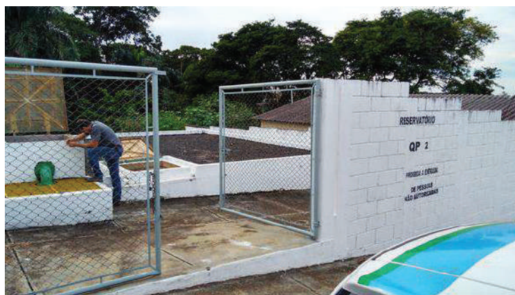
Figura 63 - Sistema Azevedo (SAz) (Setor II) - Válvula de Quebra de Pressão QP2 e Reservatório - Vista geral.
