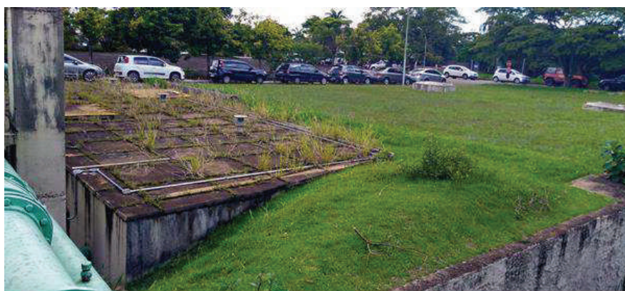
Figura 54 - Reservatório Enterrado R2.
