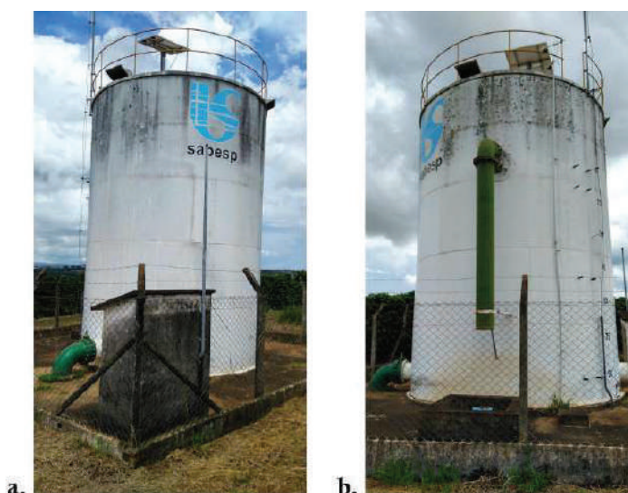
Figura 40 - Reservatório Apoiado entre EPA2 e EPA3 – Vista geral (a) e Detalhe do extravasor (b).
