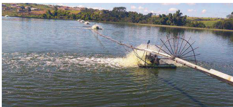
Figura 154 - ETE Paulistano I - Lagoa facultativa aerada - Detalhe dos aeradores.
