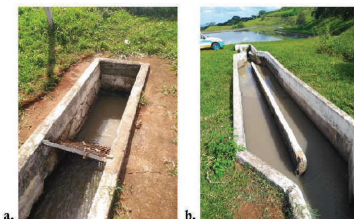
Figura 150 - ETE Aeroporto - Chegada do esgoto, gradeamento (a), caixa de areia e calha Parshall (b).
