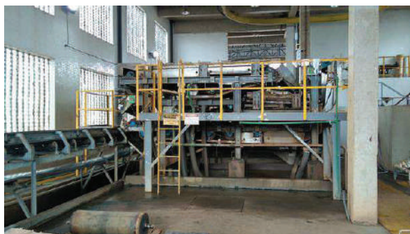
Figura 130 - ETE Franca – Setor 7 – Detalhe da Prensa de esteira.
