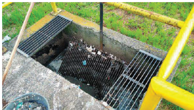
Figura 140 - ETE Jardim Luiza - Grade após o tanque de aeração.
