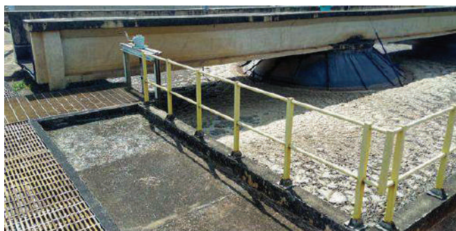
Figura 121 - ETE Franca – Setor 3 - Compartimento de entrada do TAI.
