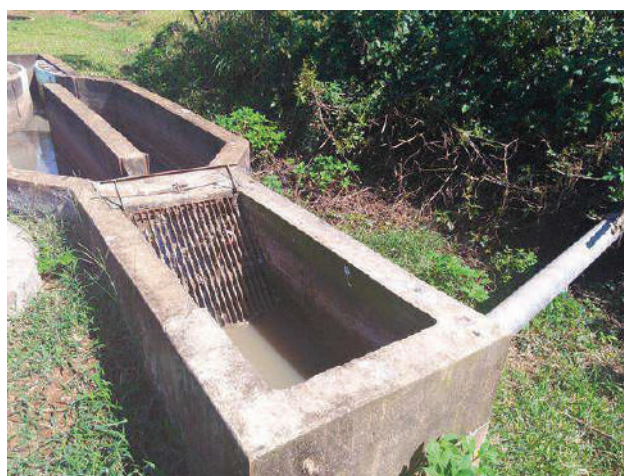
Figura 161 - ETE São Francisco - Chegada do esgoto, gradeamento, caixa de areia e calha Parshall.
