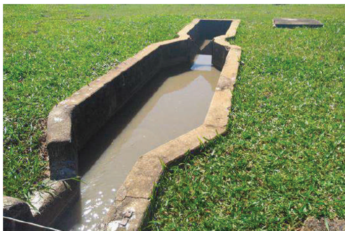
Figura 153 - ETE Paulistano I - Caixa de areia e vertedor.
