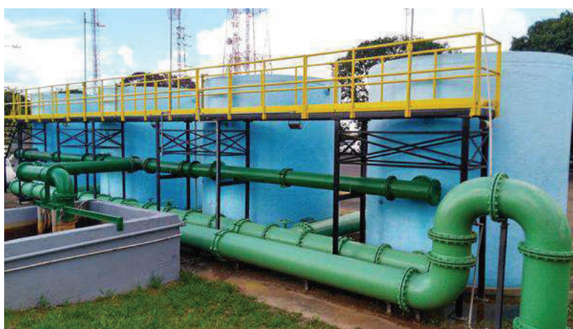
Figura 51 - ETA - Filtros - 4 filtros em fibra de vidro.
