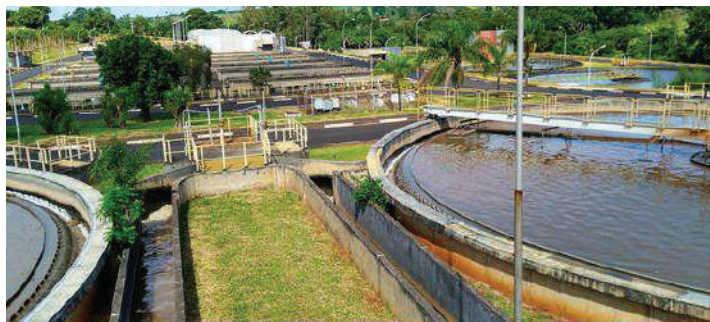
Figura 120 - ETE Franca - Setor 2 - Decantadores Primários 1 e 2.
