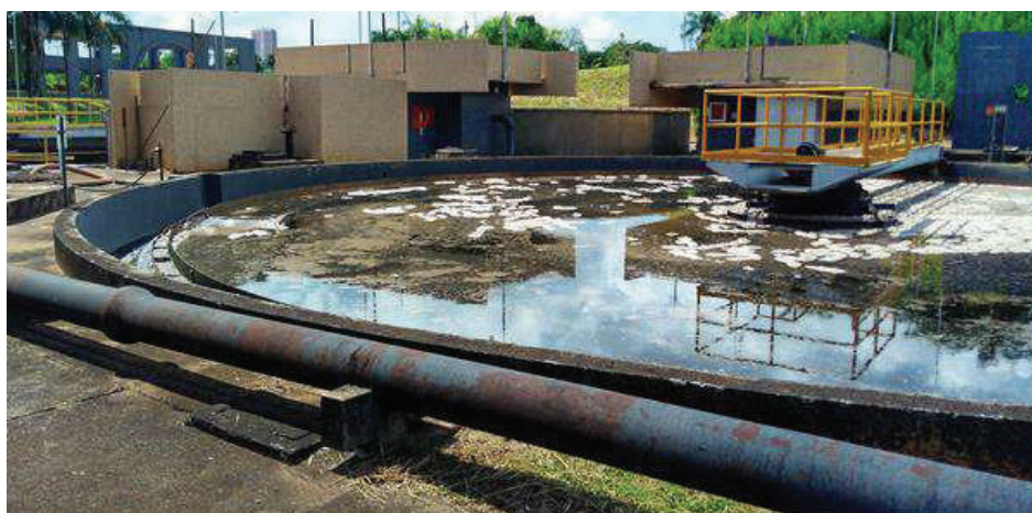
Figura 124 - ETE Franca – Setor 5 – Tanque de mistura.
