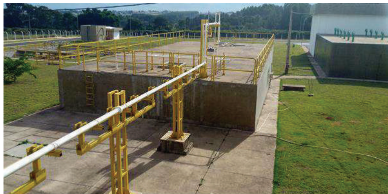
Figura 105 - ETA - Tanque de contato.
