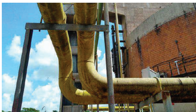
Figura 126 - ETE Franca - Setor 5 - Saída de gás dos digestores primários.
