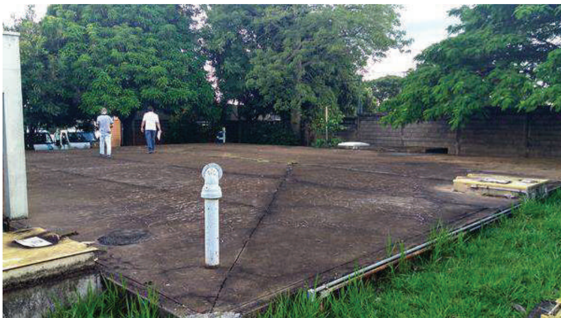
Figura 57 - Sistema ETA (Setor I) - Reservatório Enterrado R0
