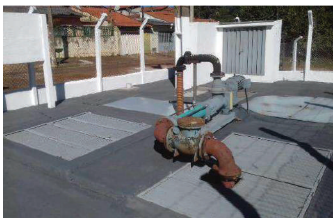
Figura 113 - EEE Palmeiras – Poço de sucção e bomba.
