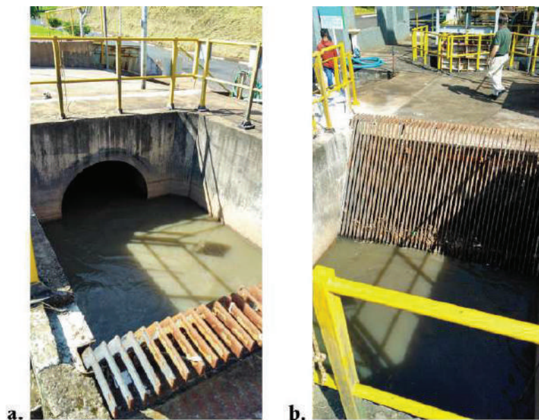
Figura 115 - ETE Franca – Setor 1 - Chegada do esgoto bruto (a) e gradeamento grosseiro (b).
