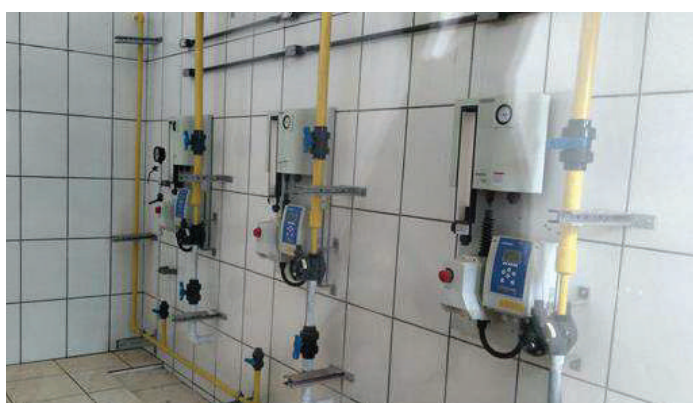
Figura 101 - ETA - Sistema de dosagem eletrônica do gás cloro.
