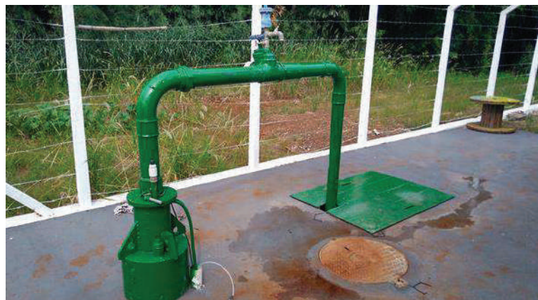
Figura 42 - Captação Subterrânea do Sistema Restinga - P1 – Vista geral.
