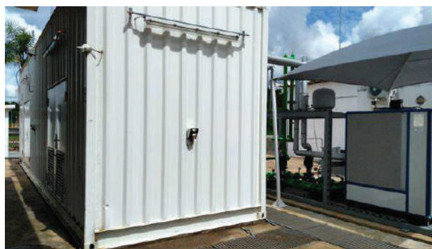
Figura 129 - ETE Franca – Setor 6 - Sistema de Beneficiamento do Biogás – Casa de operação.
