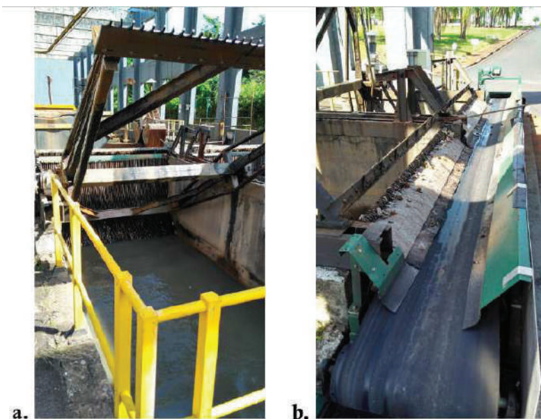
Figura 116 - ETE Franca - Setor 1 - Gradeamento fino mecanizado (a) e esteira do gradeamento fino automatizado mecanizado (b).
