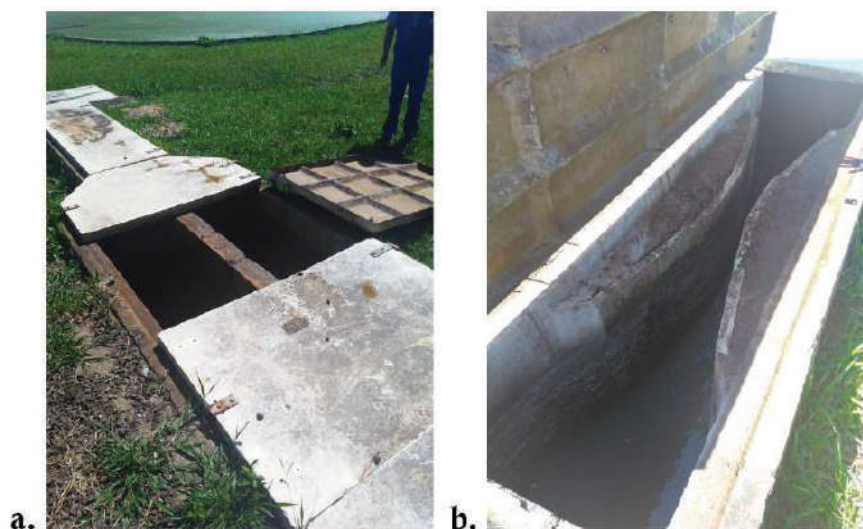
Figura 157 - ETE Palestina - Caixa de areia – vista externa (a) e calha Parshall (b).
