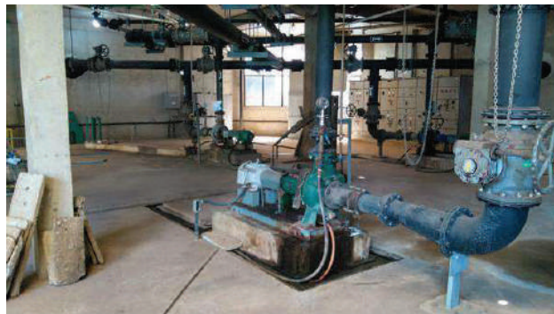
Figura 125 - ETE Franca - Setor 5 - Bombas de homogeneização.
