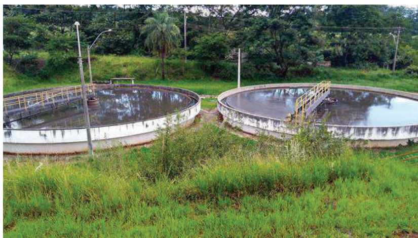
Figura 141 - ETE Jardim Luiza - Vista geral dos decantadores.
