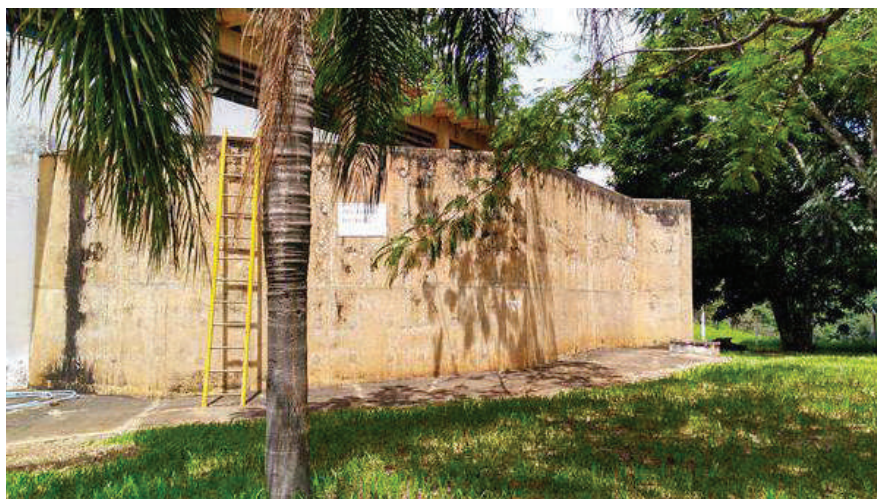
Figura 35 - EC2 - Poço de sucção – Vista geral.
