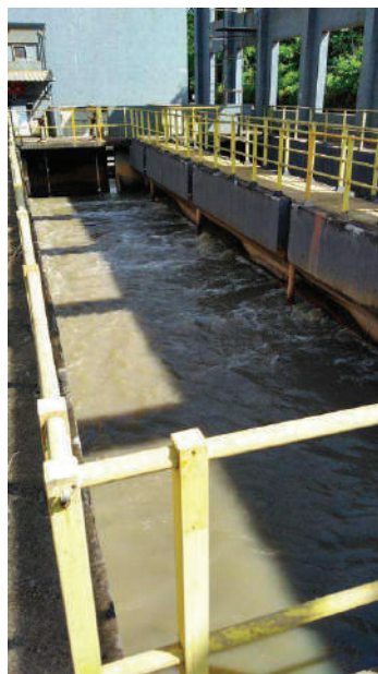
Figura 117 - ETE Franca - Setor 1 - Caixa de areia em movimento espiral airada com canaleta de areia ao fundo.
