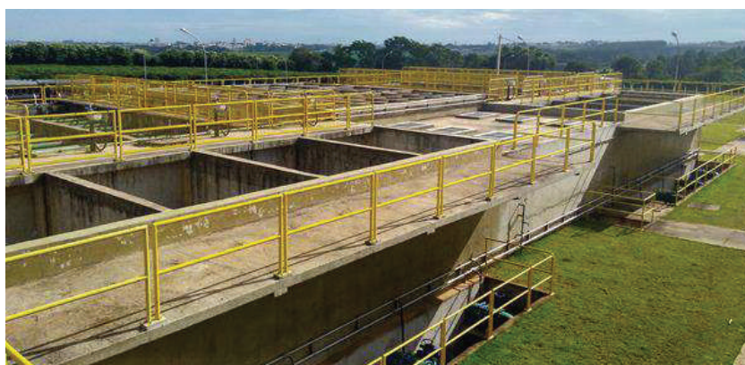
Figura 104 - ETA - Vista geral de dois módulos de floculação, decantação e filtro.
