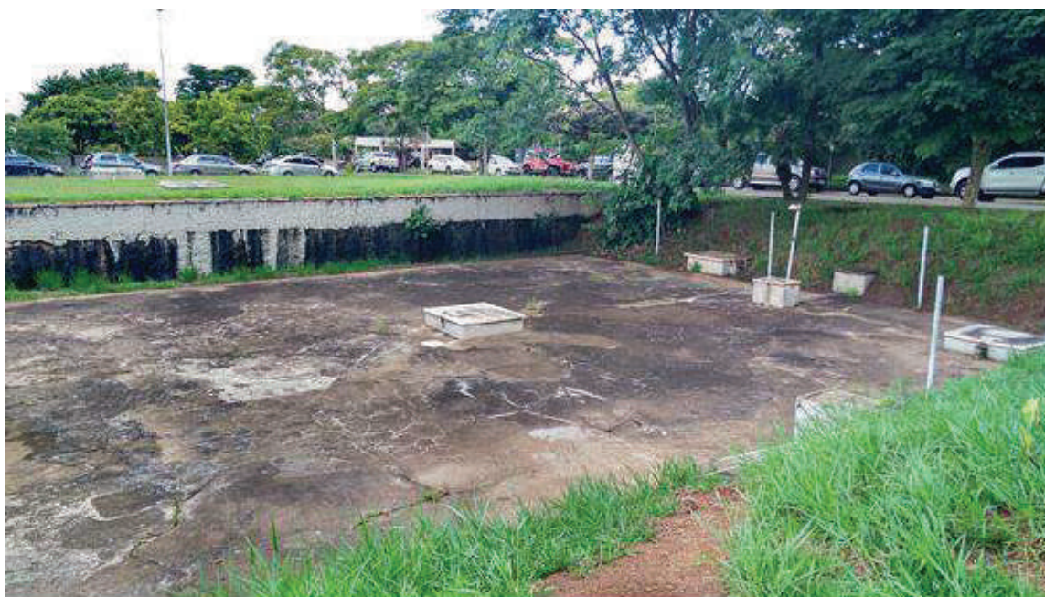
Figura 58 - Sistema ETA (Setor I) - Reservatório Enterrado R1.
