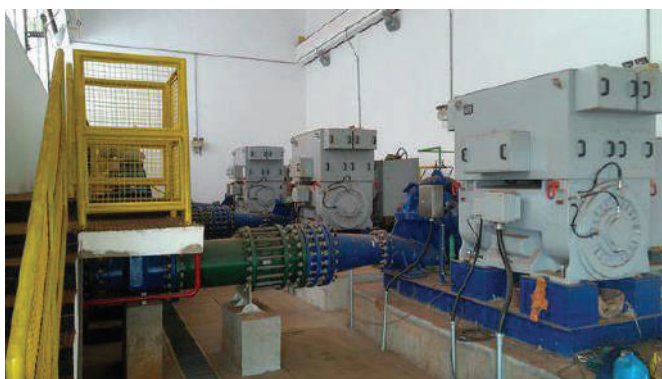
Figura 98 - EEAB 2 - Casa de bombas.
