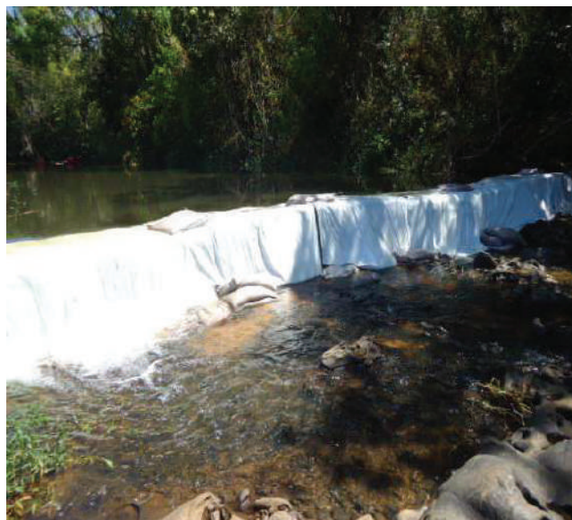
Figura 46 – Captação extra Canoas – Vista geral 1.
