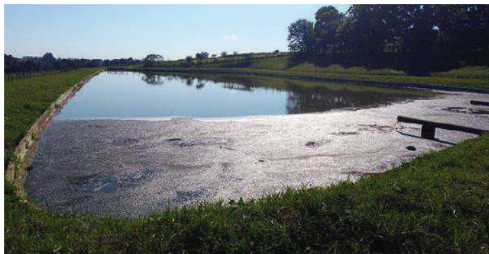
Figura 170 - ETE City Petrópolis - Lagoa facultativa.
