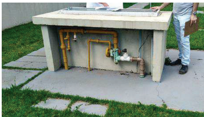
Figura 53 - ETA - Caixa de Reunião de Água Tratada.
