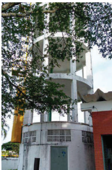
Figura 70 - Sistema Capelinha (SC) (Setor IV) - Reservatórios Capelinha - TN4.
