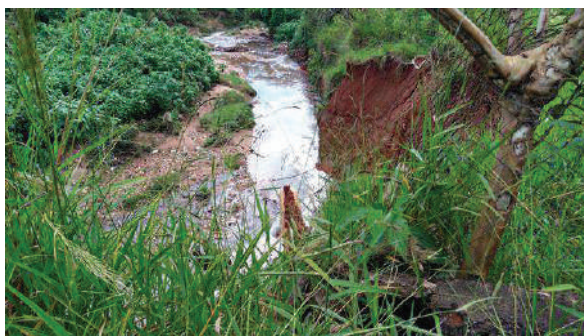
Figura 144 - ETE Jardim Luíza - Erosão no ponto de lançamento.
