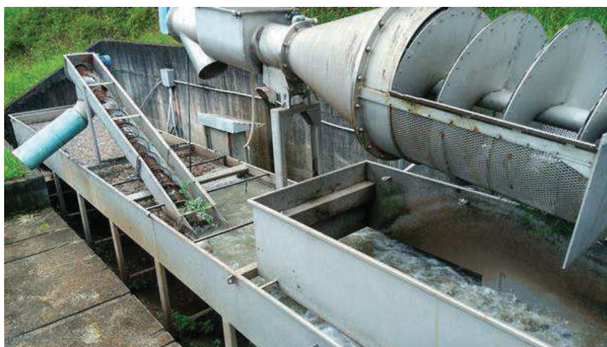
Figura 137 - ETE Jardim Luiza - Caixa de areia 2 (automatizada).
