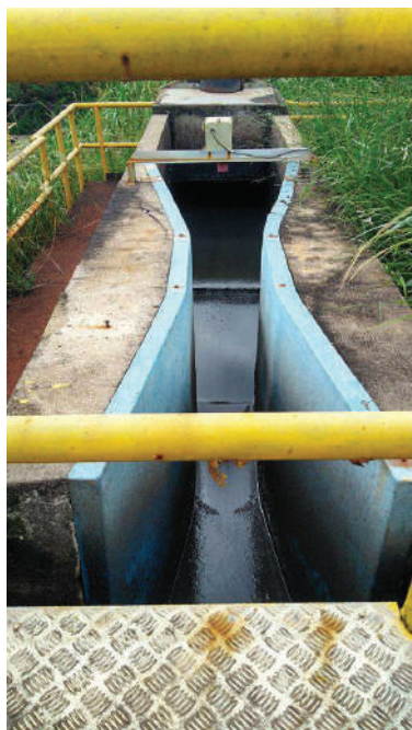
Figura 138 - ETE Jardim Luiza - Calha Parshall da chegada do lodo ativado.
