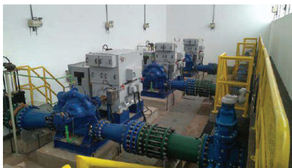
Figura 97 - Captação do rio Sapucaí-Mirim - Casa de bombas (2 conj. + 1 reserva).
