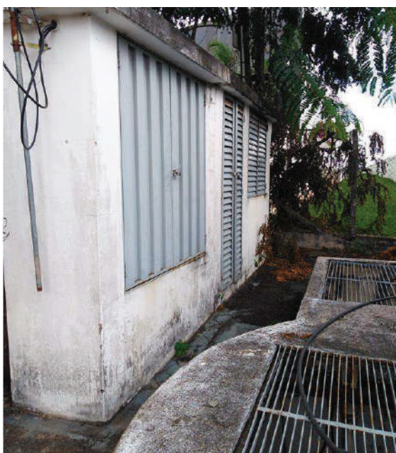
Figura 171 - EEE Morada do Verde - Poço de sucção com cesto de gradeamento e Quadro elétrico.
