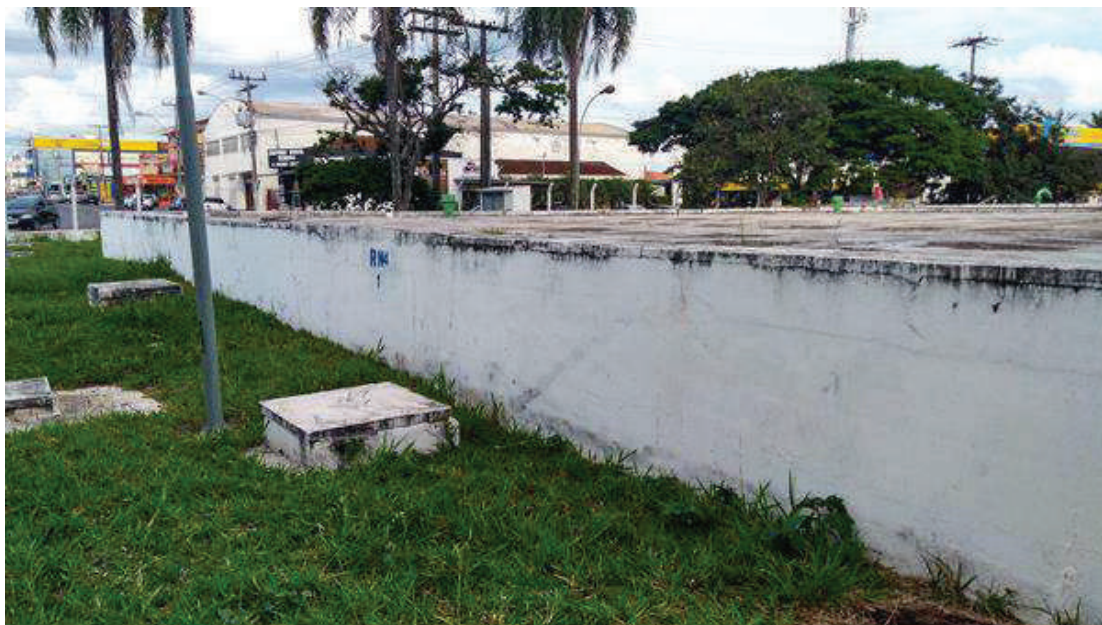
Figura 68 - Sistema Capelinha (SC) (Setor IV) - Reservatórios Capelinha - RN4.
